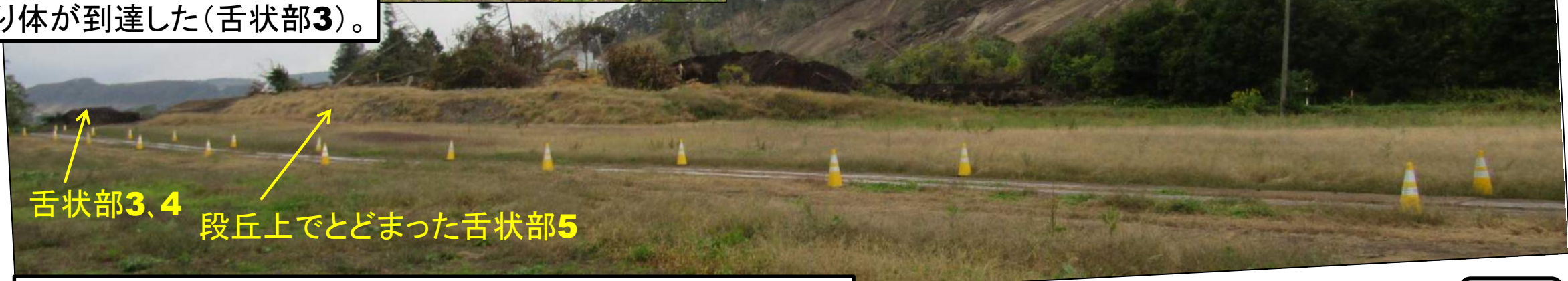
富里給水地付近崩壊・地すべり箇所を東南東からとらえる。
