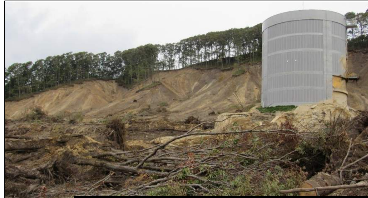
富里給水地付近崩壊・地すべり箇所西半部 (右側に付随の調整施設が消失した給水塔)
