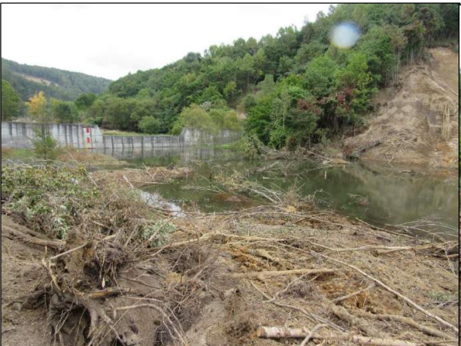
砂防ダムの上・下流側共に堰き止めで滞水
