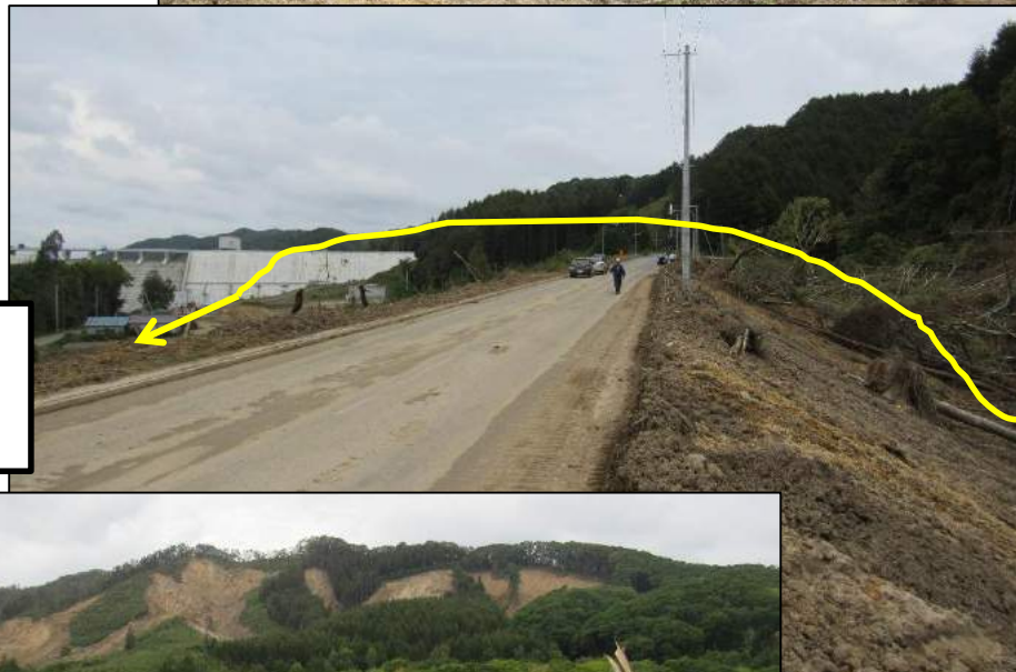
道路山側の崩壊(落)部と溝
