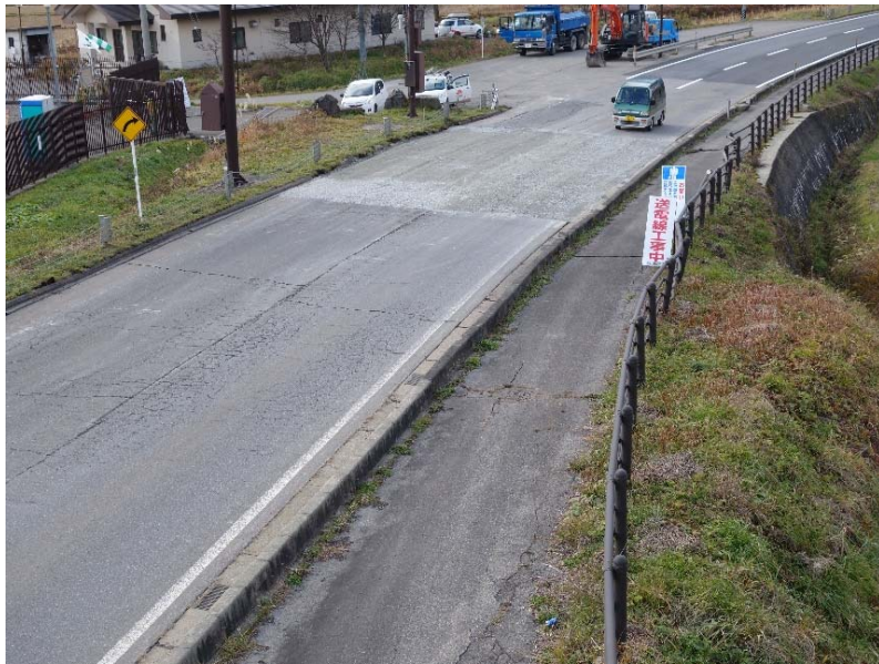
写真3：道路上における水平短縮の可能性のある変形 (神城地区の東西方向の道路上)
